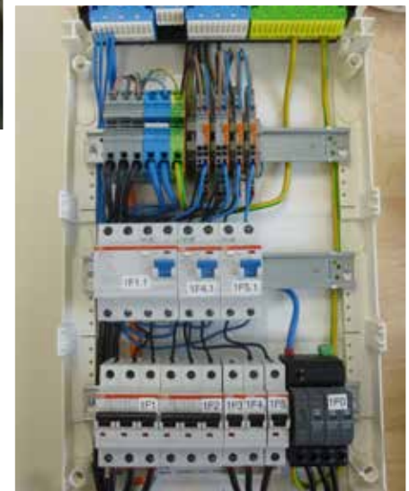
Blick auf den Verteiler der Messtafel >
